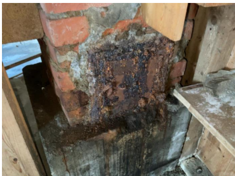
Defekt/utett sotluke i sokkeletasjen.
