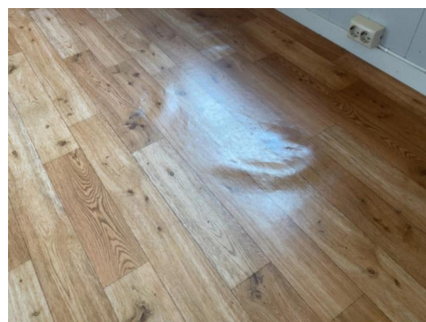
Løst belegg på kjøkken.
