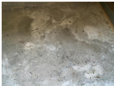
Salt/kalkutslag på gulv mot grunn grunnet fuktvandring gjennom betonggulv.
