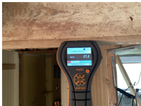
Det ble målt 27,2 vekt% fukt i bærende gulvbjelker, som er godt over anbefalte grenseverdier. Visuelle tegn på mott/stripest borebille.
