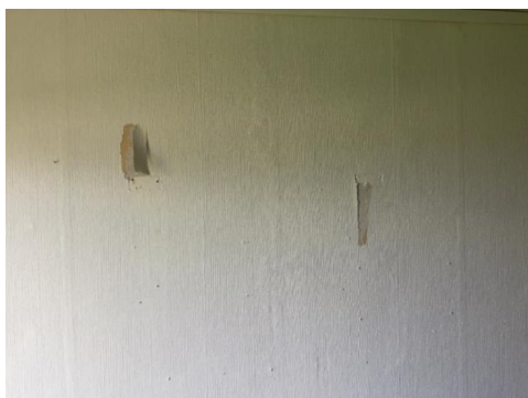
Løs/skadet tapet på i flere rom.
