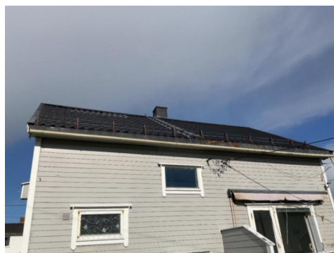
Taksid mot syd, en del plater er skiftet grunnet skade.
