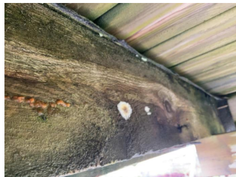
Soppangrep i bærende trekonstruksjon.
