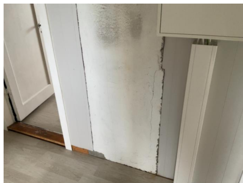
Sprekker mellom pipe/brannmur.
