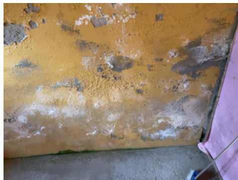
Salt/kalkutslag på grunnmur mot terreng grunnet fuktvandring gjennom vegg.
