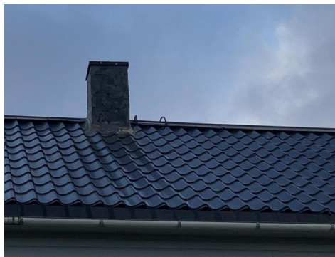
Pipe med fyringsforbud i henhold til tidligere salgsoppgave/egenerklæring.
