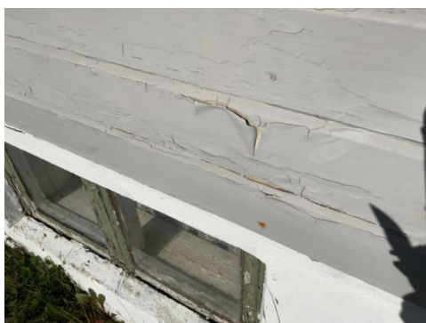
Løs overflatebehandling på deler av bordkledning.
