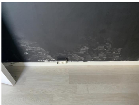
Løs/skadet tapet på i flere rom.
