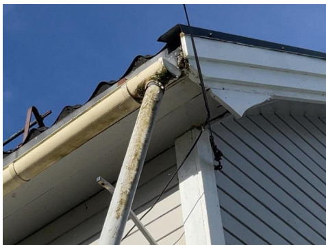
Skader/lekkasje på taknedløp.
