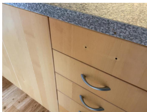
Noen fronter mangler håndtak.
