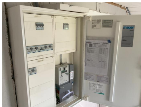
Sikringsskap på loft.
