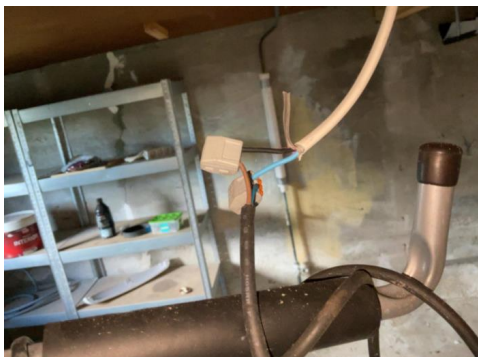
Ikke fagmessige/sikre koblinger.
