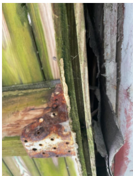
Manglende tiltak mot mus eller lignende i nedre del av kledning.
