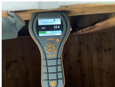
Fuktkontroll ved piggmåling viste 12,4 vekt% fukt i takkonstruksjonen som er innenfor anbefalte grenseverdier.
