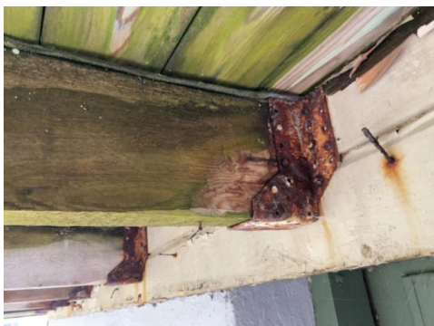
Svak innfestning av korrosjonsskadet bjelkesko i bordkledning.
