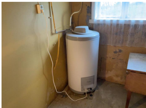
Varmtvannsbereider i sokkeetasje.
