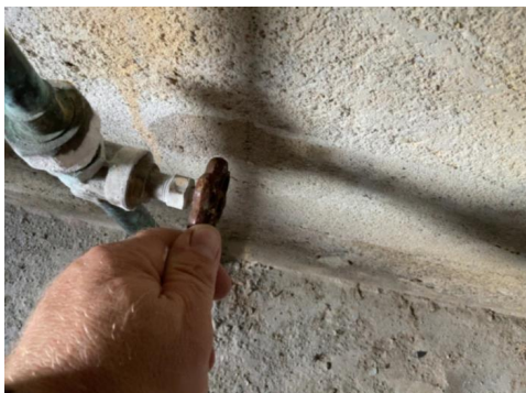
Stoppekrane er ikke funksjonell.
