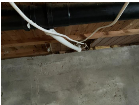
Ikke fagmessig utførelse av vannledninger/fordelingsanlegg.
