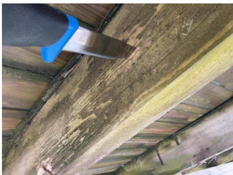
Råteskadet i bjelker/bærekonstruksjonen.
