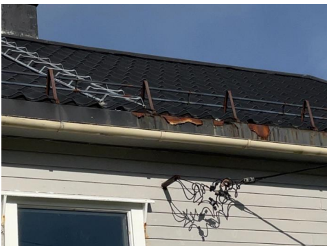
Sterk korrosjonskade på skvettblikk/snøfangerkonsoller.
