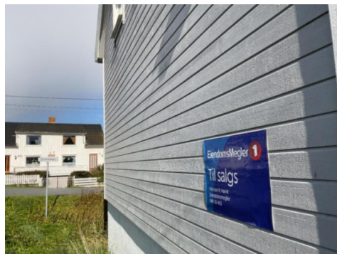
Oppdatert bordkledning på vestvegg, dato er ukjent.
