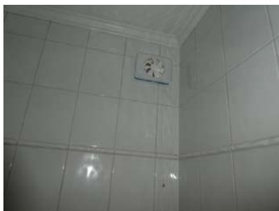
Ventilasjons viften i dusjnisen på badet
