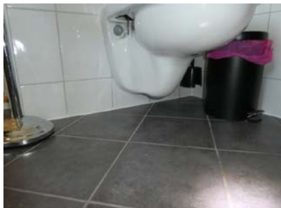
Mangler lekkasje åpning i vegg under toalettsskåla
