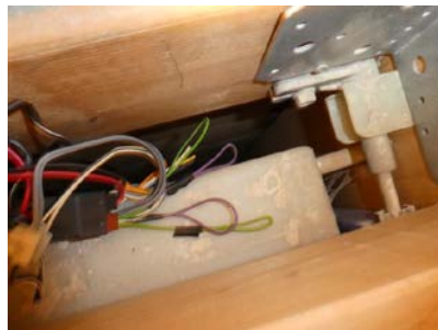
Det mangler membran i innkassingen av toalettssisternen
