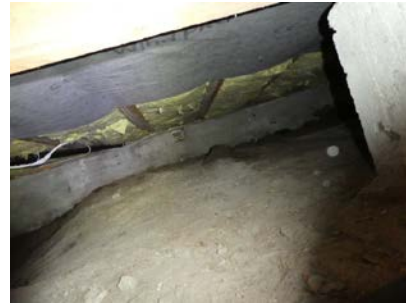
Mangler stabilisering av isolasjons sjiktet og vindtetting
