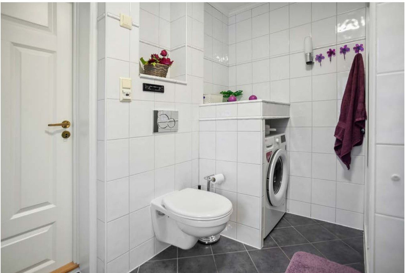
WC med innebygd systerne, samt opplegg for vaskemaskin
