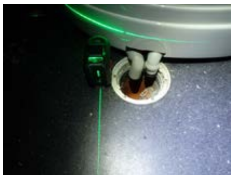
Plast "sluk" over eldre jernsluk.
