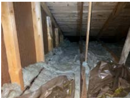
Nerker av fukt ved takfot.
