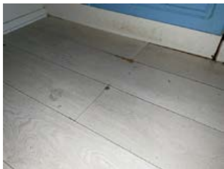
Fuktskade i gulv, kjøkken
