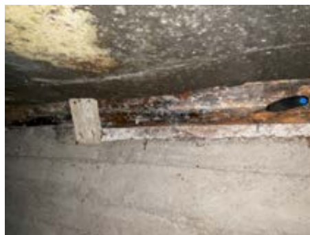
Råteskade i svill
