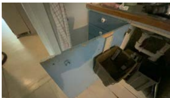
Dør er fuktskadet
