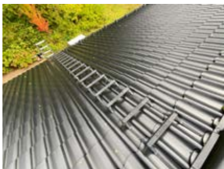
Fastmontert stige til pipe. Snøfangere montert på del av taket.
