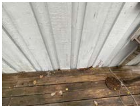
Synlig sprekkdannelse i enkelte bord.
