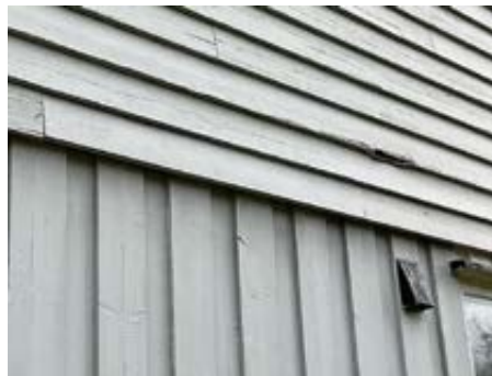
Synlig råteskade i liggende kledning i gavl vest.
