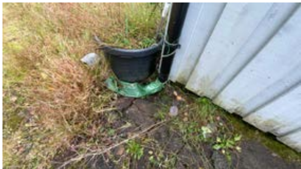
Taknedløp ført til terreng
