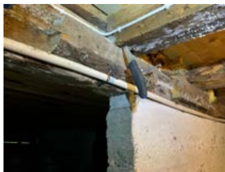
Begynnende råte i bjelke
