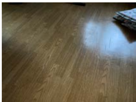
Slitasjemerker i overflaten, gulv stue.
