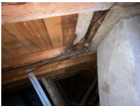
Merker eter fukt ved pipe.
