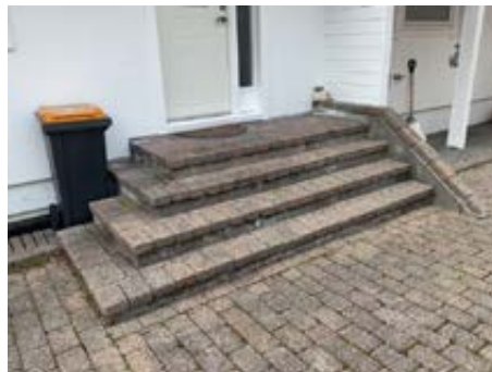
Rekkverk må monteres for å lukke avviket.
