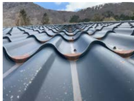
Betydelig med rust på yttertaket.
