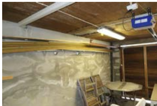
Fukt/saltutslag i pussede murer
