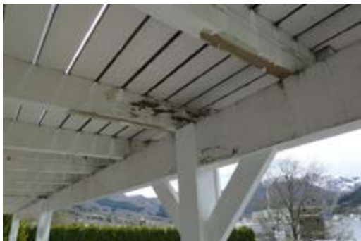
Trebjelker har slitasje og noe råteskade.
