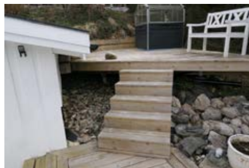
Trapp uten rekkverk.
