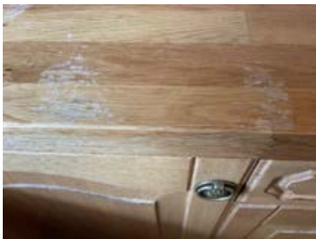
Slitasje på benkeplate og fronter.
