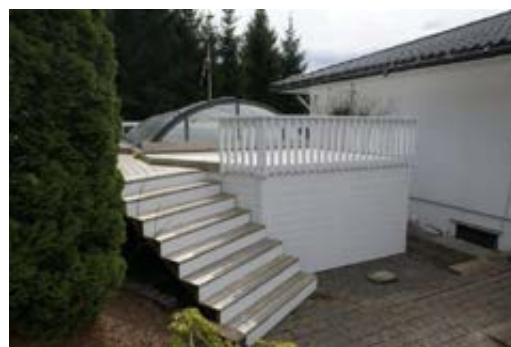
Trapp uten rekkverk.
