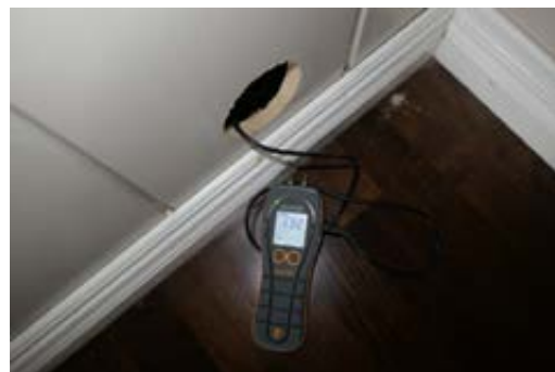
Hulltaking er foretatt i vegg under trapp uten å påvise unormale forhold.
