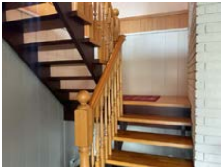
Det mangler håndløper på vegg i trappeløpet.
