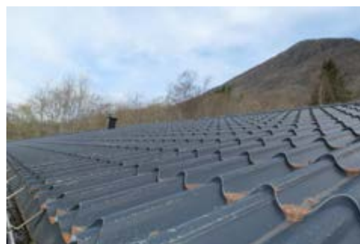
Betydelig med rust på yttertaket.
