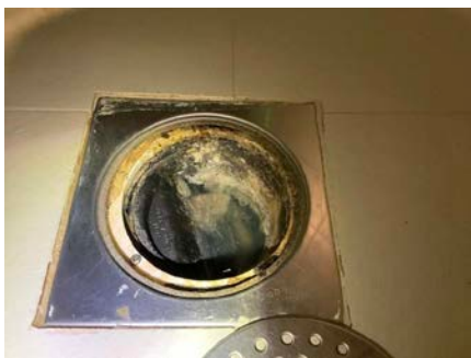
Sluk bad 1.etasje
