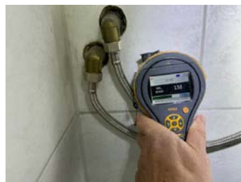
Mansjett er ikke etablert på rør-føringer i vegg bak dusj-kabinett.
