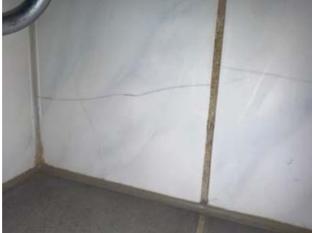
Sprekk i veggflis.
