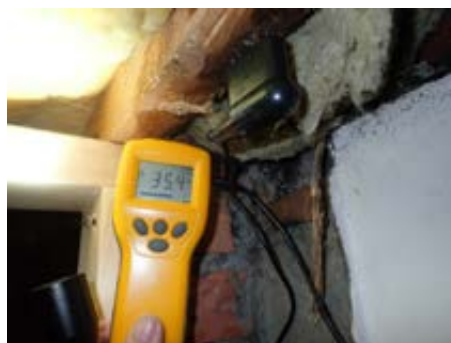
Registrert fukt i treverk ved pipe.
