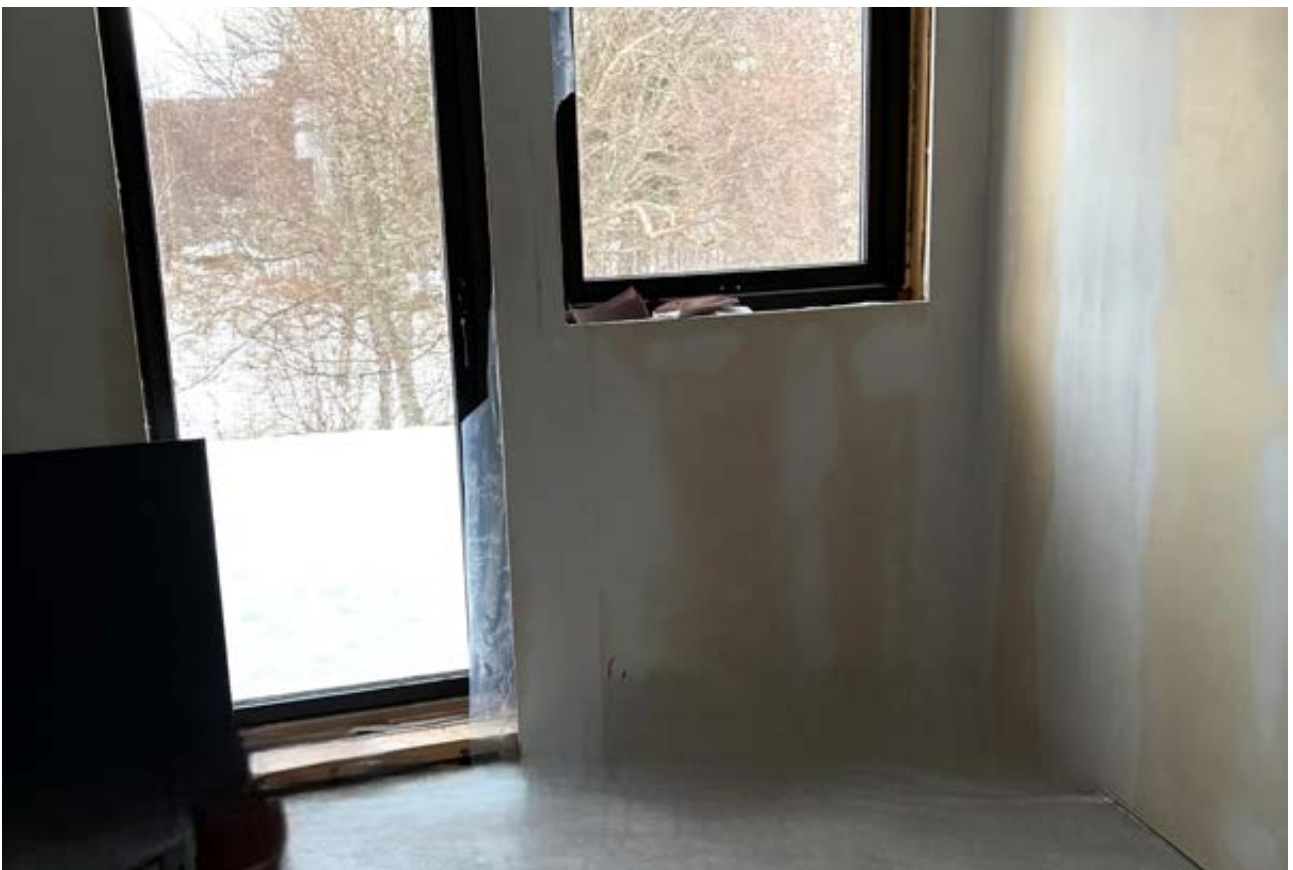
Inngang til rom i kjeller fra nedsiden av boligen - påbegynt, ikke ferdigstilt
