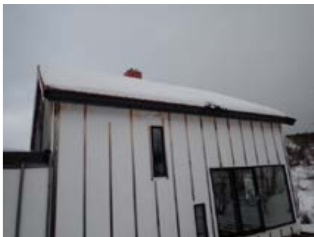
Taktekk er overdekt med snø
