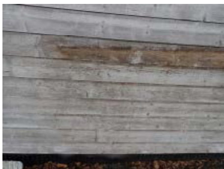
Parti helt bortslitt maling østvegg med skader
