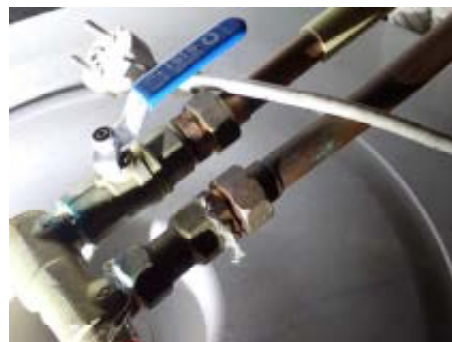
Stoppekran på vann til vv-tank
