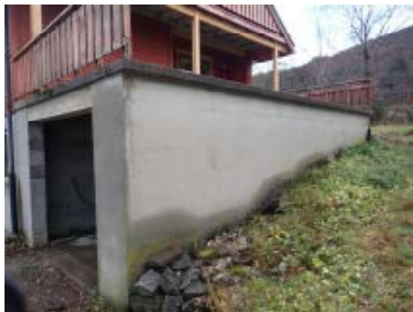
Manglende utvendig fuktsikring mur
