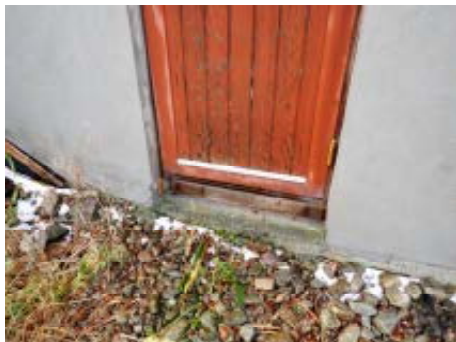
Ikke støpt under kjellerdør nord
