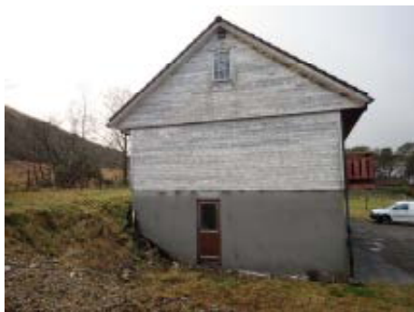
Nordvegg malingsslitt og skadet kledning
