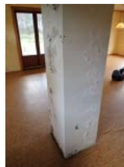
Viser krakelering i pusset pipe i stue etter fukt/lekkasje
