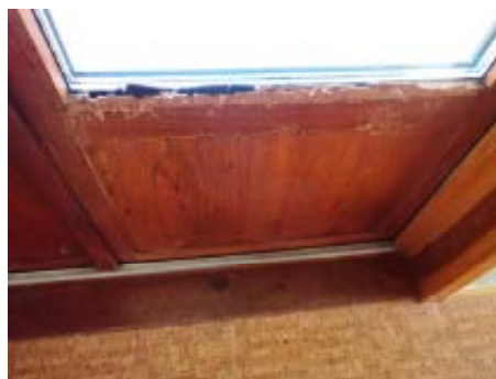
Balkongdør stue - skader på innsiden - forsøkt tetting mot glass
