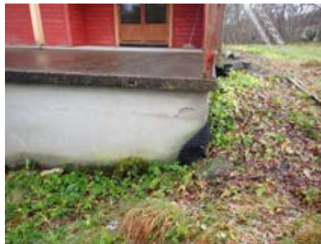
Horisontal sprek i mur/murpuss fra hjørne sørøst
