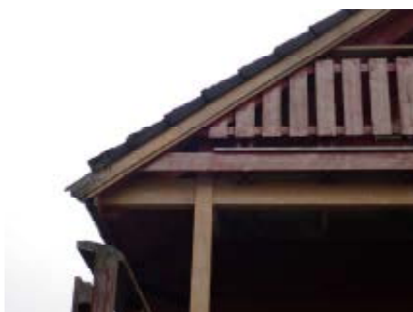
Råteskader i vindskibord balkong sørøst
