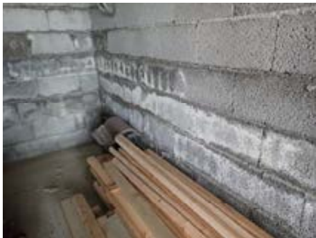
Synlig saltutslag/fukt innvendig mur
