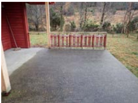
Rekkverk mangler - rekkverk som står igjen har skader
