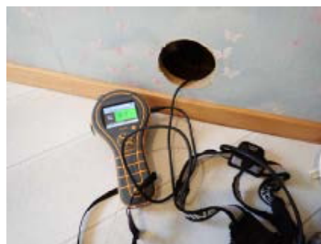
Målt ca 10 % som er tørt i vegg
