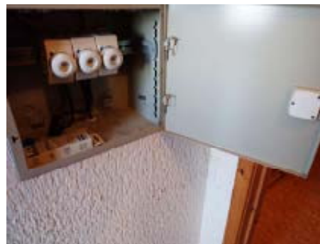
Inntaksskap med skrusikringer
