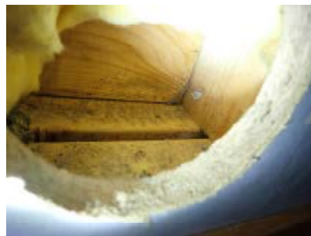
Ser at der er fuktmerker
