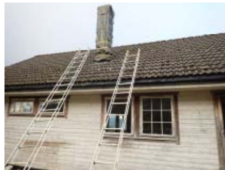
Sprekk i pipe - pipe mangler pipeovertrekk og provisorisk kledd inne med plast.
