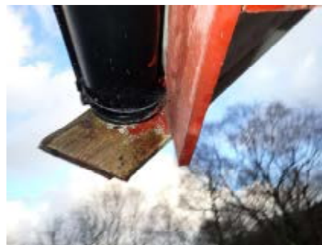
Råteskader i vindskibord balkong nordvest
