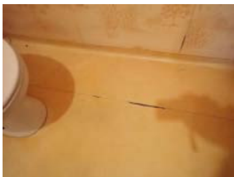
Sprekk i belegg
