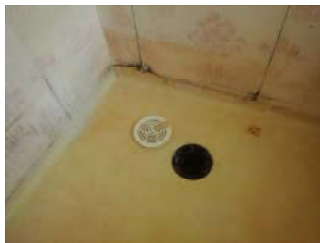
Skade i overflater i dusjen
