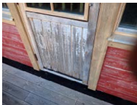
Balkongdør loft med skader
