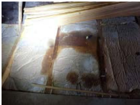
Viser lekkasje fra lagret væske/olje av et slag
