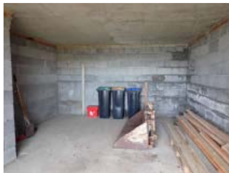
Synlig saltutslag/fukt innvendig mur
