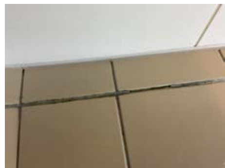
Riss i fuger i dusjsone.
