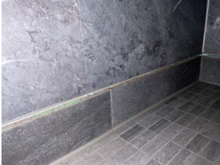
Sprukket silkonfuge mellom sokkelflis og bunnlister.
