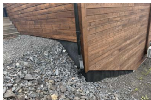
Oversiktsbilde der slutførelse av grunnmur ikke er montert i henhold til monteringsanvisning.
