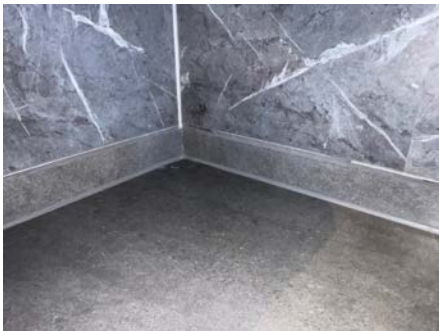
Ujevne glipper mellom sokkelflis og våtromsplater.
