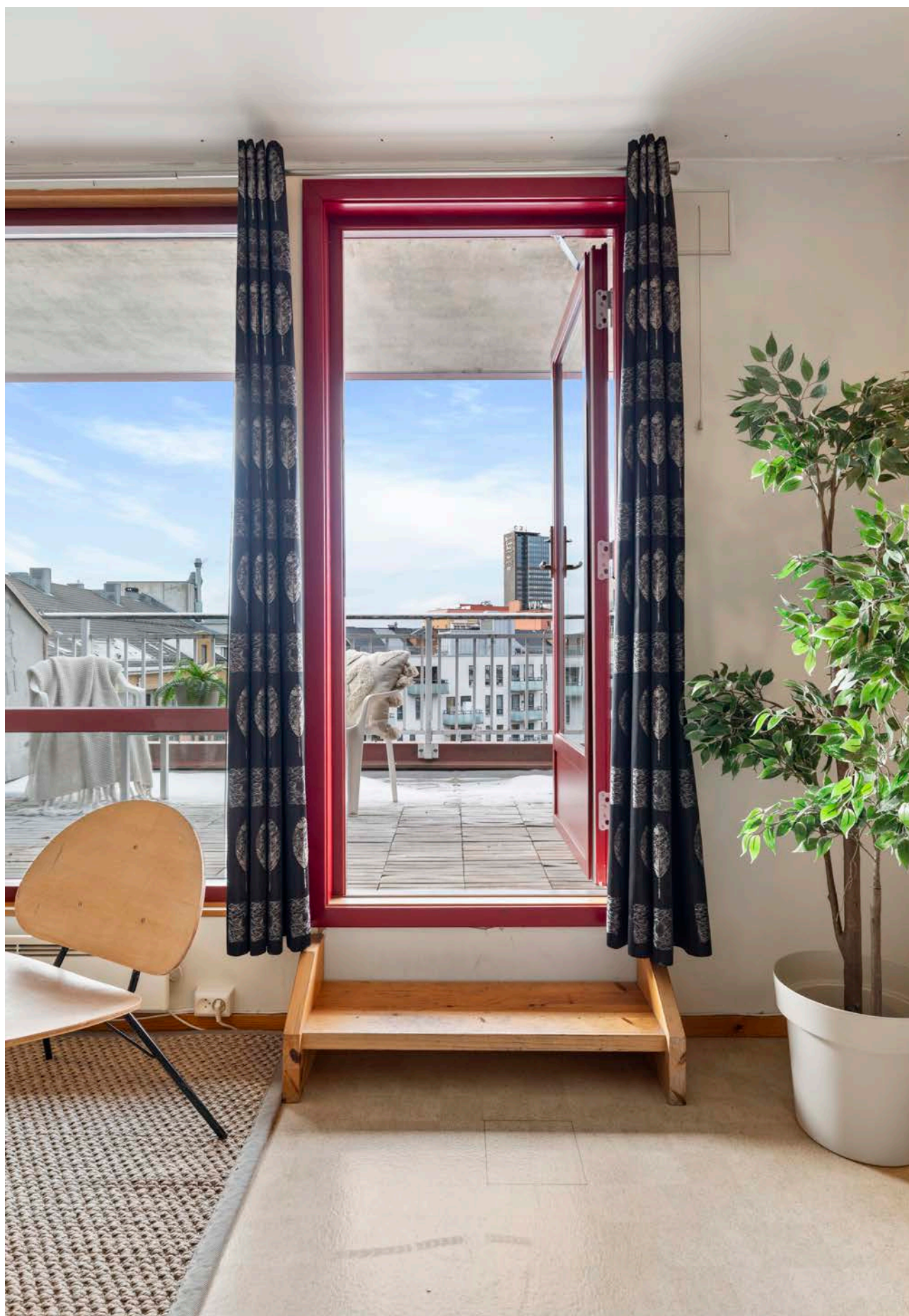
Balkongdør med 2-lags glass fra 2017.
