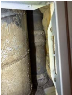
Plast avløpsrør bak luke i stue 7 etg
