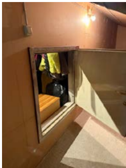
Rømningsdør for evakuering, loft
