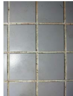
Sprekker i flisefuger på vegg og gulv.
