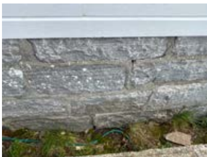
Mindre sprekker i gråsteinsmur.
