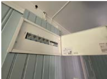
Sikringsskap i 2. etasje
