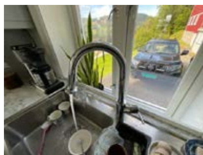
Vindu går lenger ned en benkeplaten bak oppvaskbeslag.
