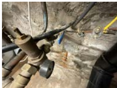
Stoppekran i kjeller.
