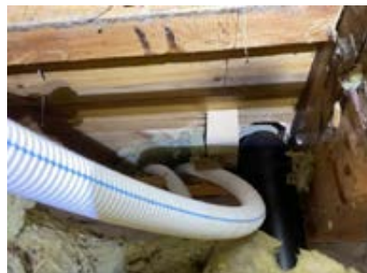
Mulige inngangsveier ved avløpsrør gjennom bjelke.
