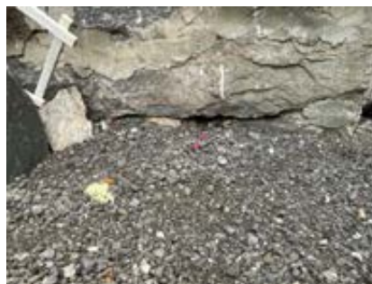
Mindre sprekker i gråsteinsmur.
