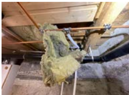
Muelort observert opp på isolasjon i bjelkelaget.
