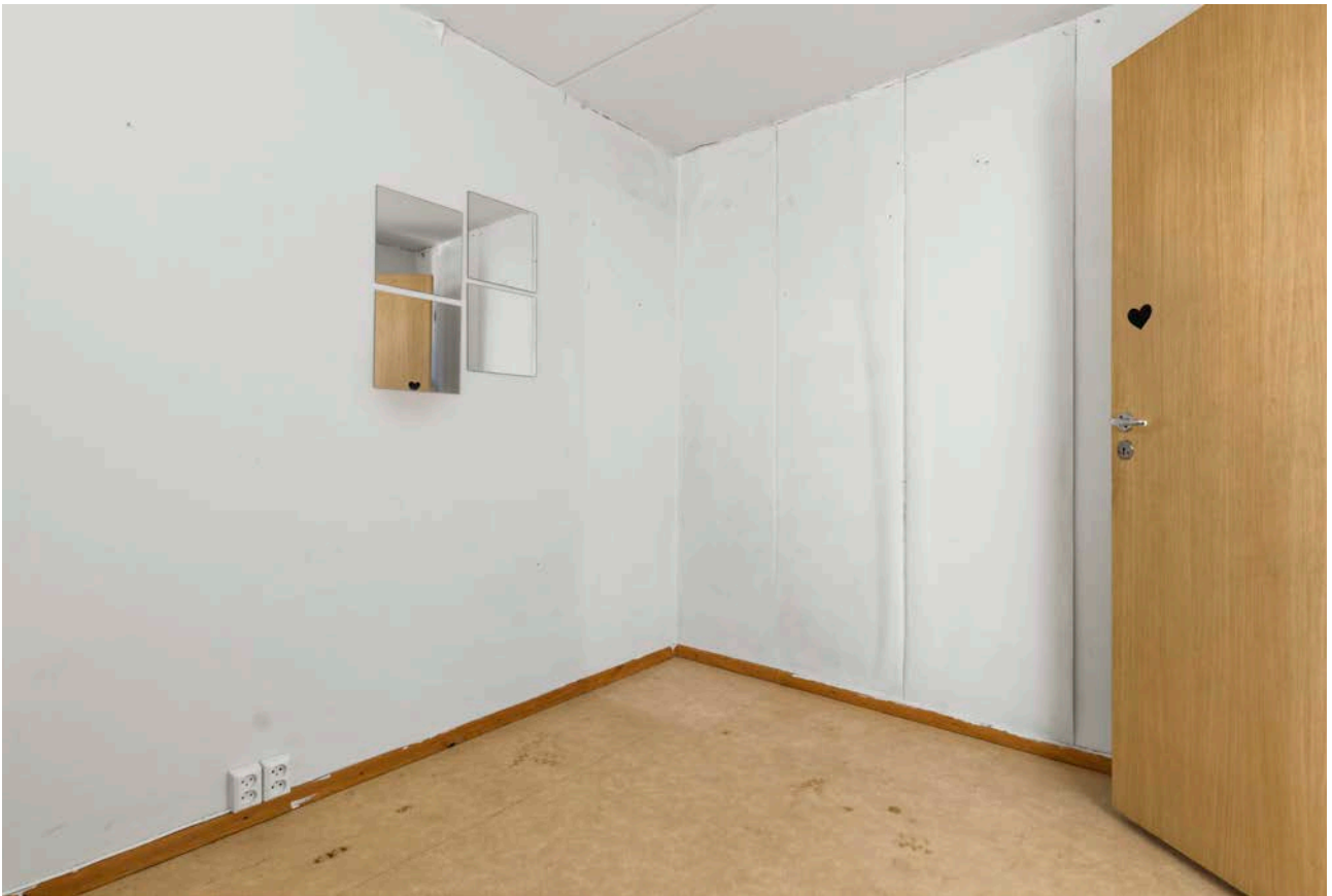
Innvendig bod i dag innredet som sovealkove. Rommet har ikke vindu ut og kan ikke godkjennes som soverom.
