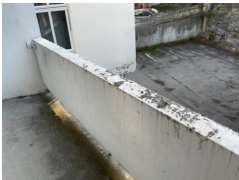
Rekkverket er malingsslitt
