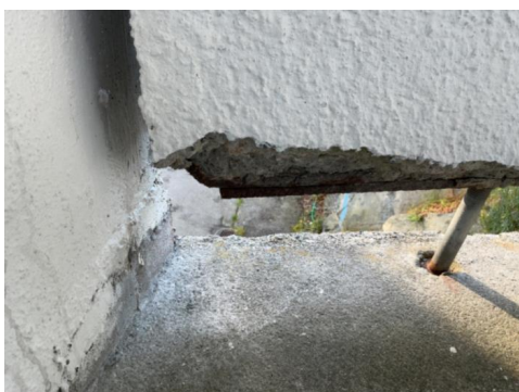
Rustsprenging og noe løs betong på rekkverket.
