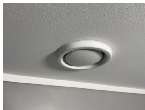
Avtrekksventil i himlingen
