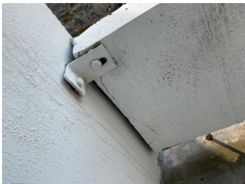
Sprekker i rekkverkselement
