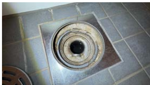
Synlig membran under slukens klemring.
