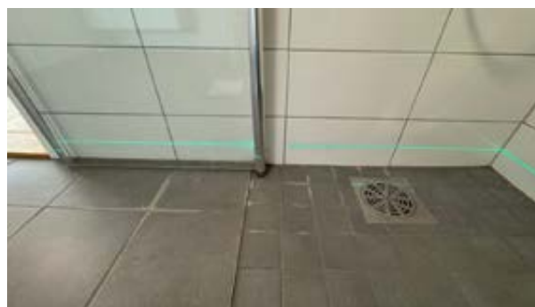
Kalkutslag i partier skyldes normalt utilstrekkelig fall i membransjikt under fliser.
