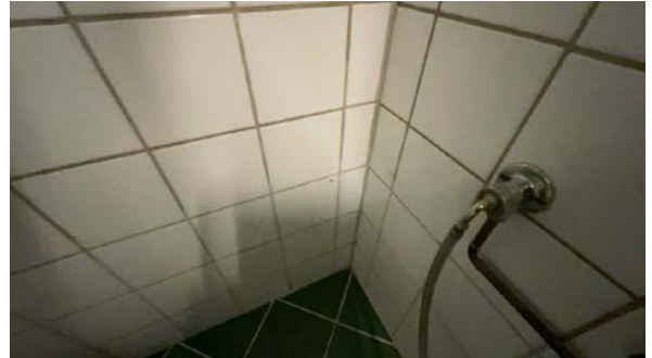
Synlige skruerull på vegger.
