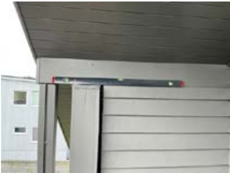
Noe sig i konstruksjon over balkong.
