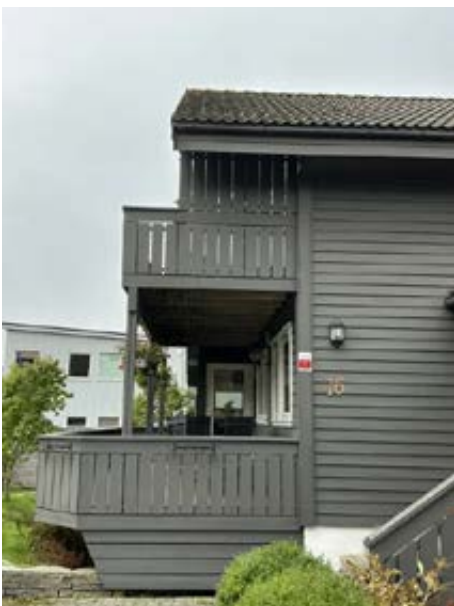
Søyle fra takkonstruksjon på til balkong uten søyle under. Det er lagt dobbel bjelke på balkong.
