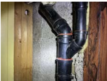
Avløps-rør i kjeller er tett med silikon i noen skjøter.
