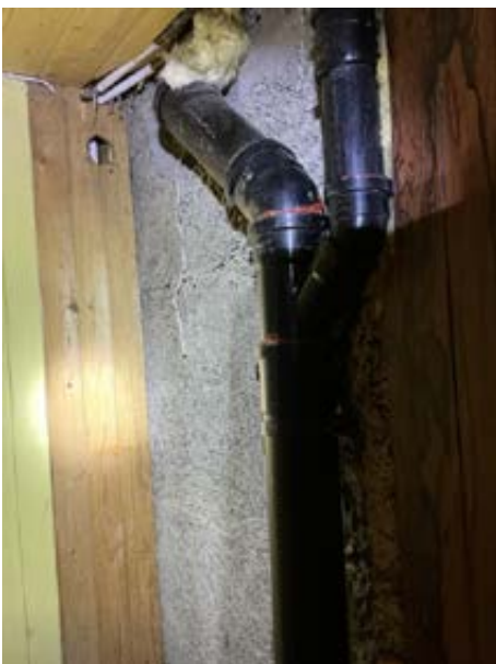
Grunnmur med synlig siporex i innvendig kjeller.
