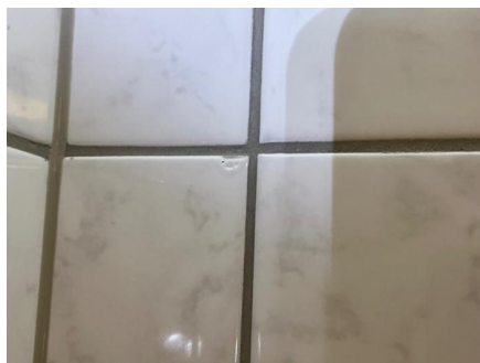
Skade på flis. Dette er i liten grad.
