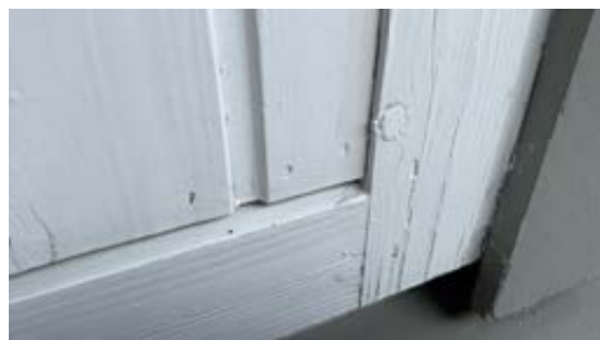
Altandør soverom, oppsprekte overflater
