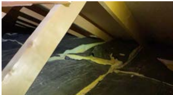
Stedvis avslitt papir/vindsperre
