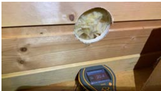
Målt ca 20% ved gulvnivå
