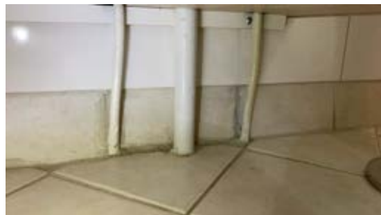
Rørgjennomføringer i våtsone ved gulv.
