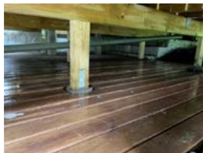
Nedløp ført under altan/platting
