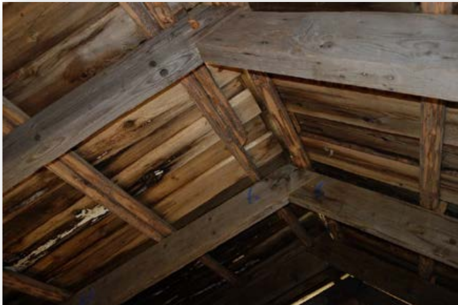
Solid konstruksjon, men takborda tek til å bli dårlege
