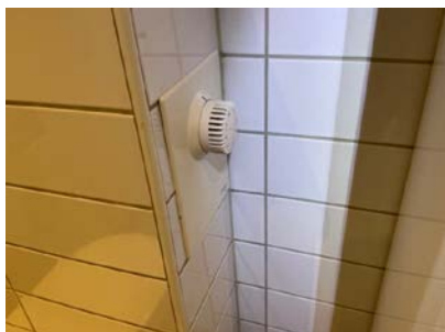
Varme i gulv reguleres med regulator-ventil.
