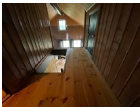
Mangler returgelender rundt trappeåpning.
