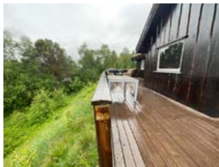
Skjevt rekkerk på terrasse ut fra kjøkken
