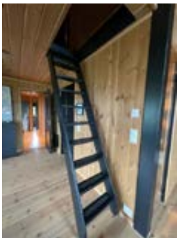
Mangler rekkverk og håndløper.
