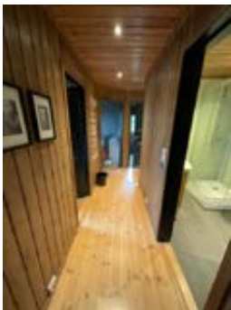
Gangareal, laveste punkt inn mot soverom i enden av bildet.
