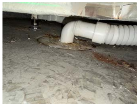
Sluk under dusjkabinett.
