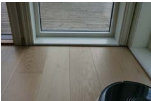
Betongsåle mot yttervegg/sjøen har et nedseg på 10 mm.
