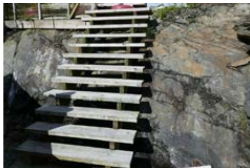
Her må rekkverk monteres på hver side.
