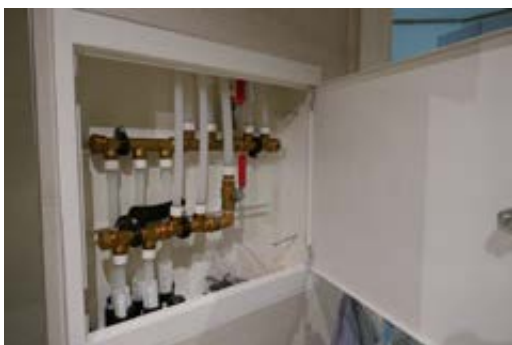
Vannfordelingsskap mangler innholdsfortegnelse.
