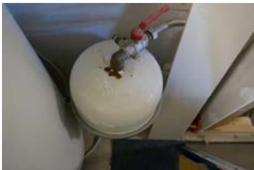
Trykktank er tilkoblet vannledning, for å gi et godt vanntrykk.
