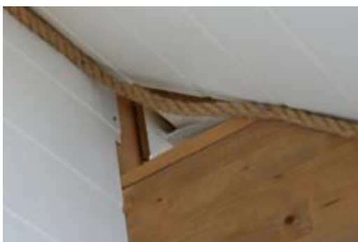
Panelplater i loftstue har mangelfull tilpasning over drager.
