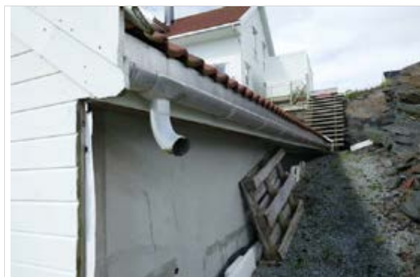
Manglende hjørnebord, taknedløp og klemlist på platon grunnmursplate.
