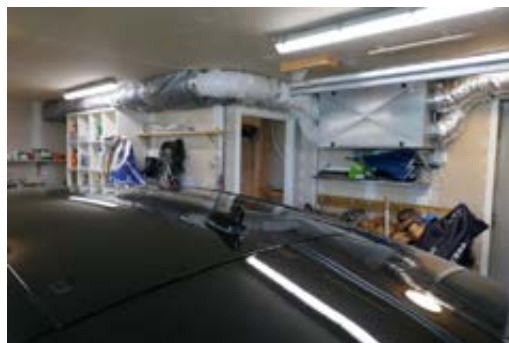
Aggregat og kanaler i garasje.
