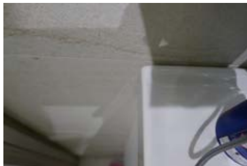
Det kan synes som at benk ikke er påført silikon mot vegg.
