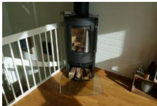
Vedovn og pipe er nylig montert.
