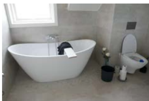
Bad i 2. etasje. Badekar er plassert under vindu, men det anses ikke her som et avvik.
