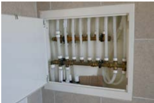
Vannfordelingsskap mangler innholdsfortegnelse.
