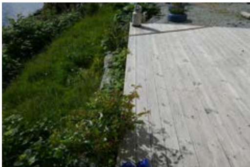
Terrasse ut fra hoveddel mangler rekkverk.
