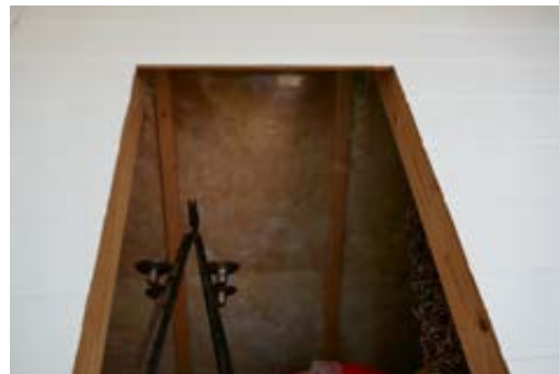
Utsparing til kryploft er ikke imontert dør.
