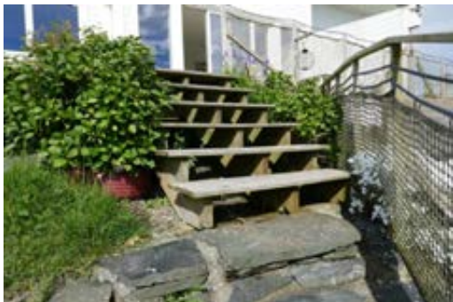
Her må rekkverk monteres på hver side.
