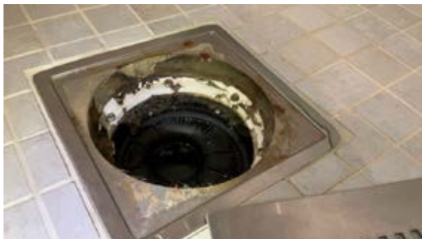
Sluk fra byggrår i bad mot øst
