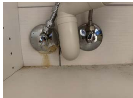
Mulig gammel lekkasje i servantskap. Det er ikke fukt på befaringen.
