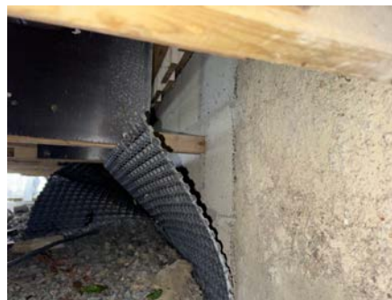
Knotteplasten henger ut fra veggen.
