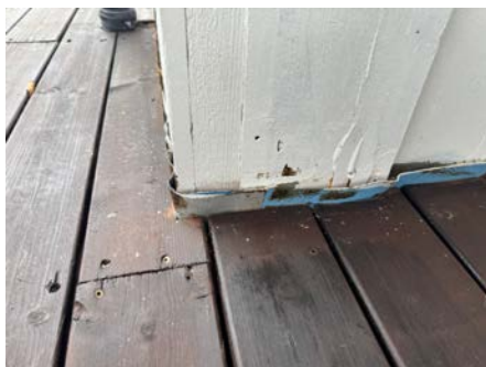
Oppkant på membran er ikke beskyttet med beslag.
