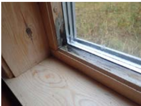
Råteskader i vindu.
