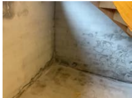
Spor av fuktighet på mur/gulv i kjeller.
