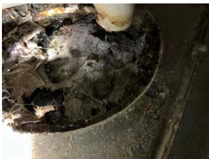
Sluk bad i underetasje
