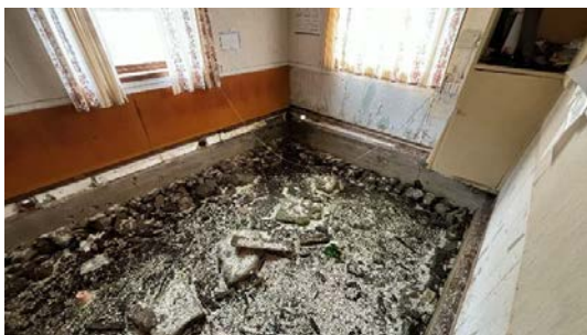
Det ene kontoret lengst sørøst mangler gulv.
