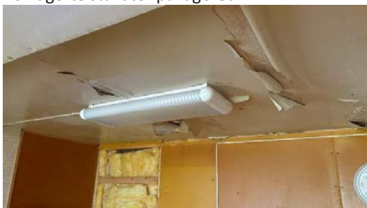
Avskalling på noen rom i kontordelen.
