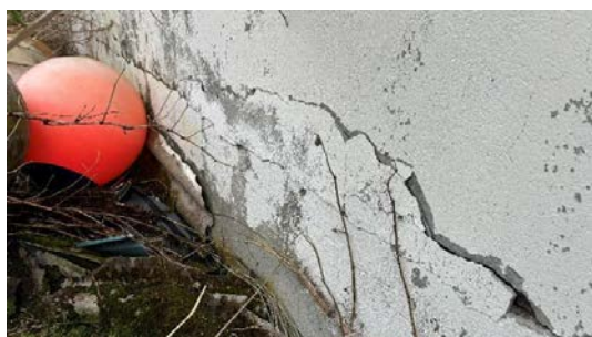
Avskalling og sprekker på utvendig puss.
