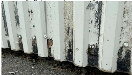
Fasadeplatene er værslitt, og har begynt å gå i oppløsning.
