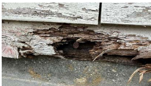
Råteskadet bordkledning og bunnsvill.
