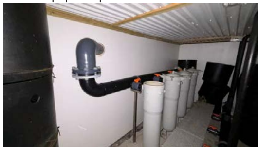
Vannsystem som er tilknyttet pumperommet.
