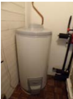
Varmtvannsbereder i teknisk rom.
