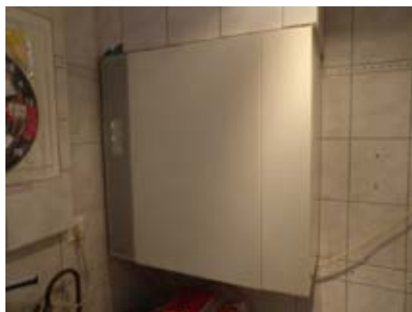
Balansert ventilasjon til leilighet.
