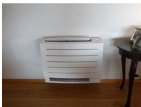
Varmepumpe i stue.
