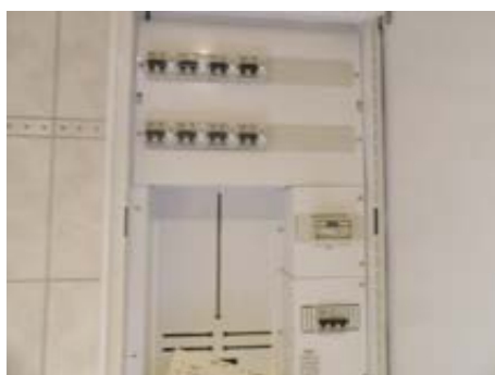
Sikringsskap på vaskerom leilighet 1.
