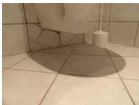
Knut fliser ved toalett.
