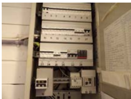
Sikringsskap i teknisk rom.
