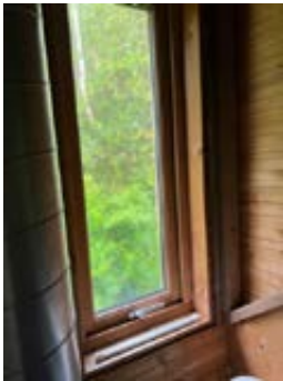
Mangler lister rundt vindu i kott. Muligens punktert glass.
