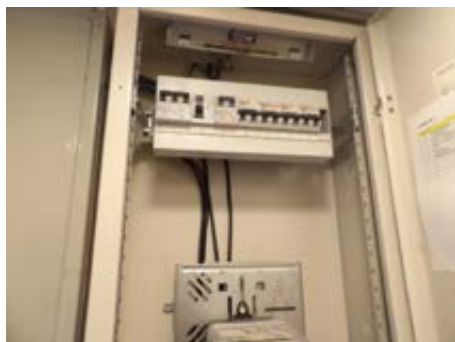
Sikringsskap i teknisk rom.
