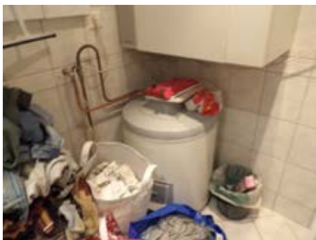
Varmtvannsbereder i bod i garasje.
