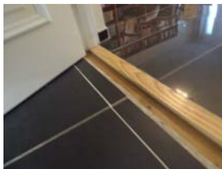
Lav oppkant til terskel. Fliser delvis under terskel.
