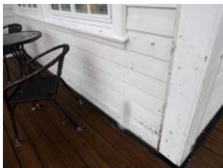
Noe slitasje på kledning.
