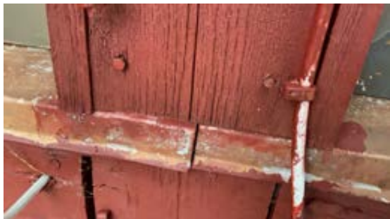
Trevirke oppsprukket, i kontakt med beslag
