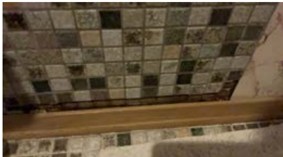
Fuktskade og avvik våtsone
