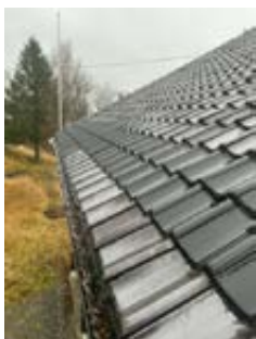
Ulike takstein, takstein som gliper mot hverandre
