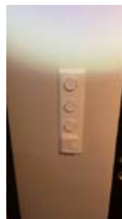
Nyere installasjon, ikke samsvarserklæring i boligen.
