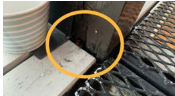
Råte søyle v/altan hovedetasje
