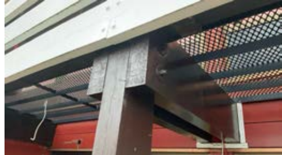
Knutepunkt for bæresystem, utsatt for værslitasje
