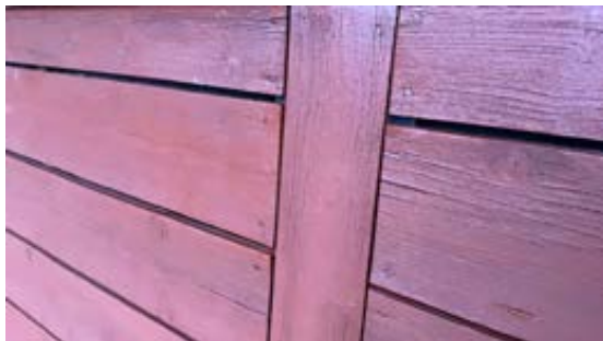
Værslitasje og oppsprekte bord
