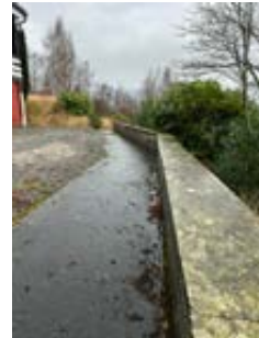
Setning/skjevhet mur foran bolig
