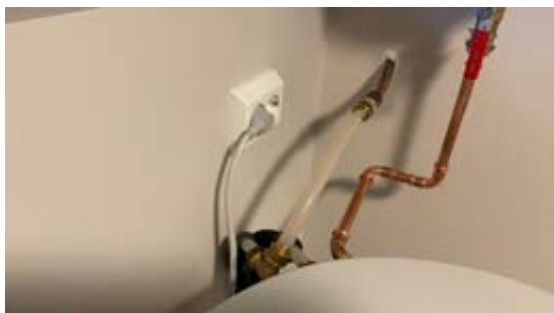
Nyere installasjon, ikke samsvarserklæring i boligen.
