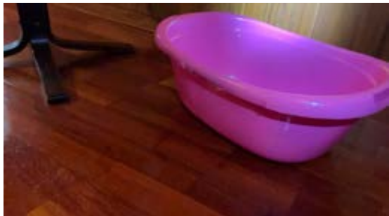
Pågående fuktinntrenging - kar for oppsamling
