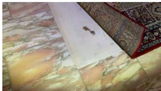
Hall/entre mangler flis ved dør
