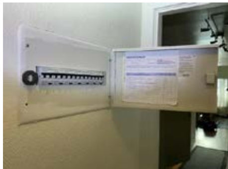
Sikringsskap står i entre.
