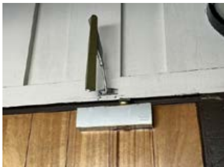
Dør-pumpe til inngangsdør er defekt.
