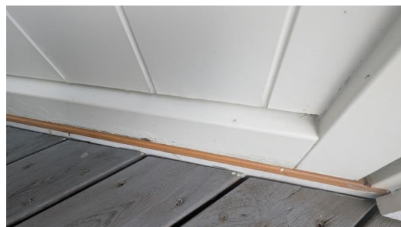
Begynnende fukt/råteskade på terrassedør.
