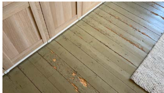
Stedvis overflateskader trebord
