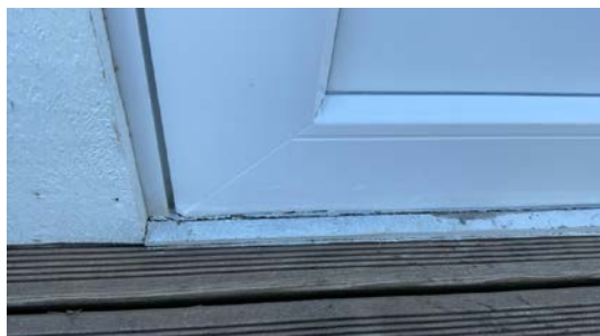
Manglende beslag under dør altan
