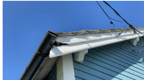
Parti med råte i vindskie, ved inngang/trapp
