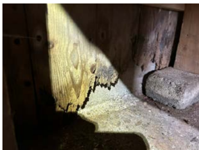
Påvist fukt/råteskade i delevegg mellom de to romma
