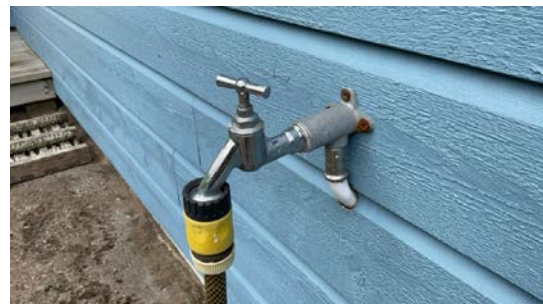
Utekran uten selvdrenerende løsning, ikke fagmessig utført arbeid.
