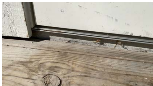
Manglende beslag under hoveddør
