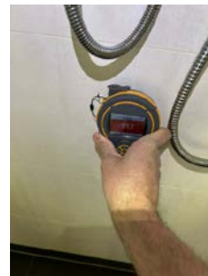
Fuktindikasjon under dusjbatteri
