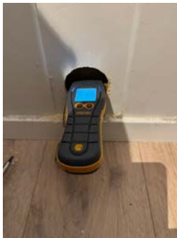
Fuktmåling i hulrom i vegg bak dusjen.
