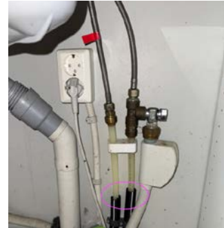
Manglende tettemuffer i benkeskapet på kjøkkenet.
