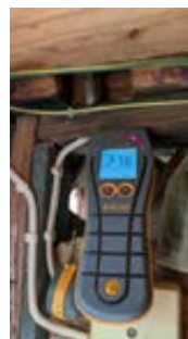
Fuktskaded tømmer sett fra innen/undersiden.
