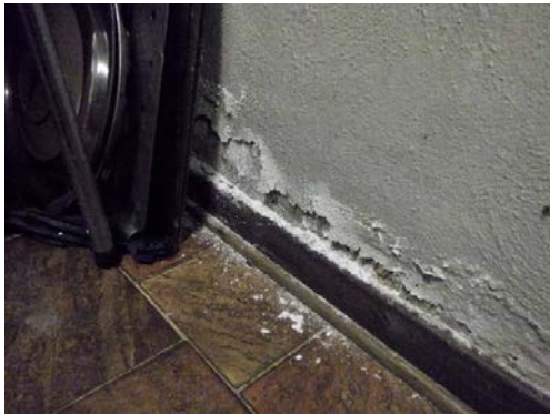
Saltutslag grunnet fuktopptrekk i betongvegger i bussgarasjen.
