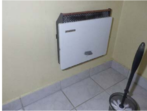
Panelovner på de fleste rom av ulik alder.
