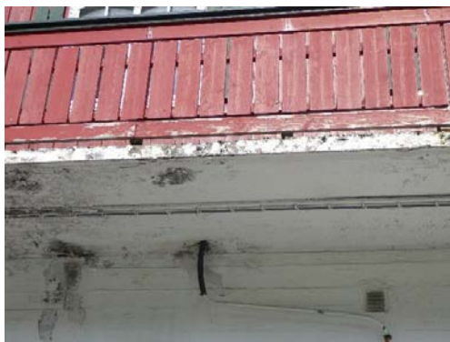
Armeringskorrosjon på utkraget balkong.
