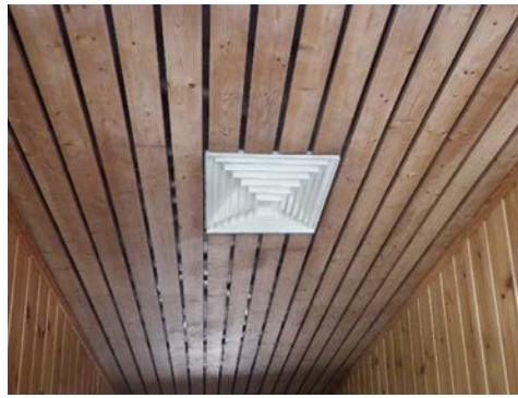
Spaltepanel i fellesareal/trapperom.
