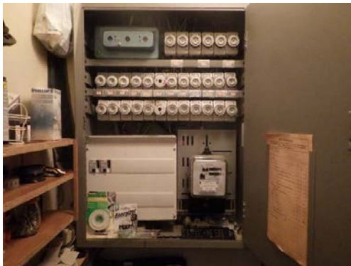
Sikringsskapet i leiligheten.
