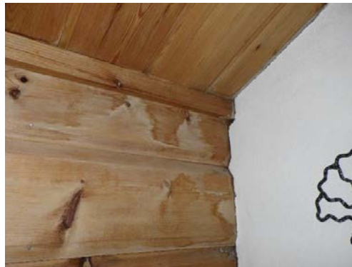
Fuktspor på vegg i overgang mot himling i peis stue.
