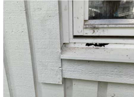
Ikke fagmessig utført, risiko for vanninntrengning
