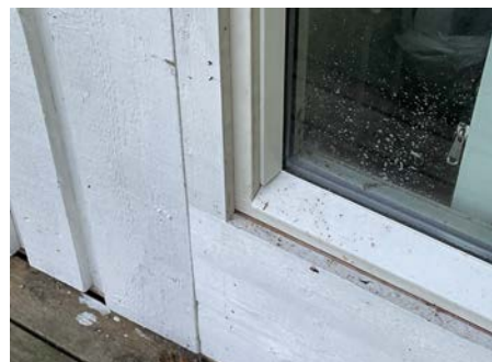
Avvik knyttet til innsettsdetaljer, samt manglende vannbrett
