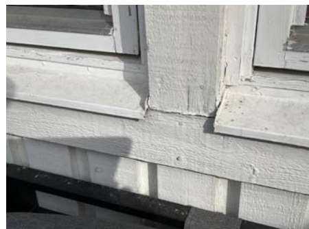
Arbeider som ikke er utført fagmessig.
