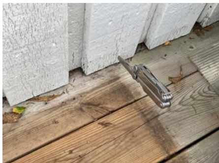
Råte i nedre del av kledning
