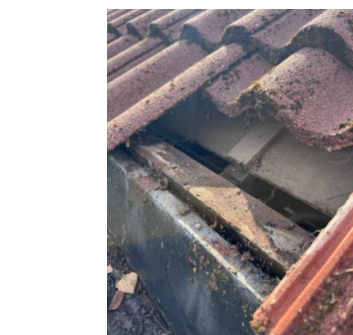
Ikke fagmessig utført, risiko for vanninntrengning
