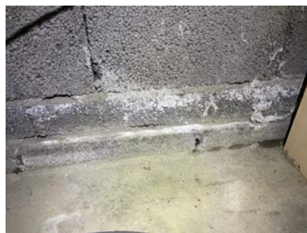
Saltutslag på vegg
