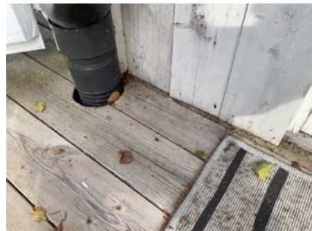
Arbeider som ikke er utført fagmessig.
