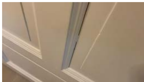
Riss i overflater
