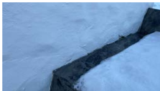
Noe løsna puss
