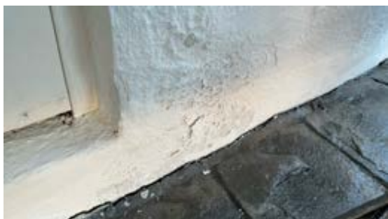
Noe løsna puss
