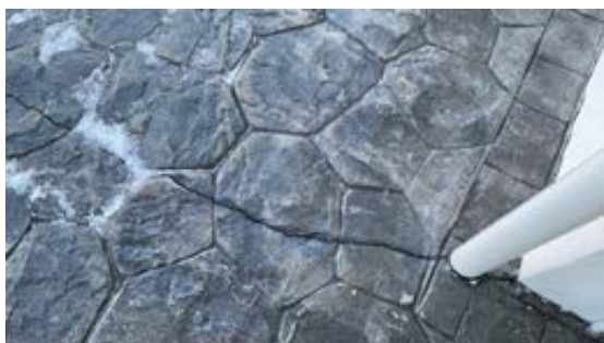
Sprekke i dekorbetong
