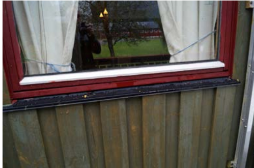
Et stuevindu er slitt og må skiftes
