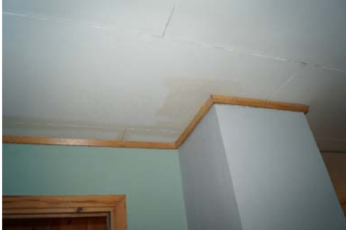
Eldre fuktskjolde i himling på stue
