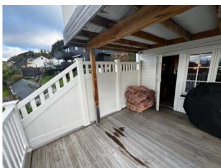
Bilde visert det er lekkasje i dreneringssystemet.
