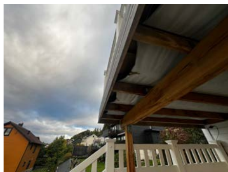
Det er ikke etablert takrenne/taknedløp på dreneringssystemet.
