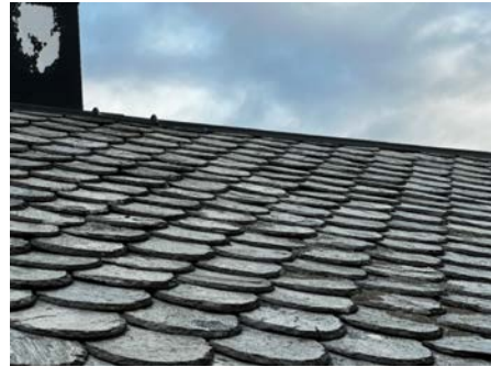
Oversiktsbilde, det er registrert flere en 3 steiner som har store åpninger.
