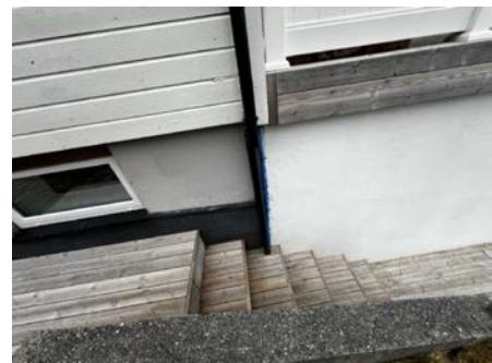
I dette området/overgang mellom eksisterende del og tilbygg det er påvist fukt.
