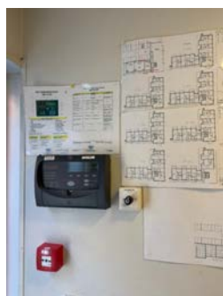
Felles brannvarslingsanlegg i bygget
