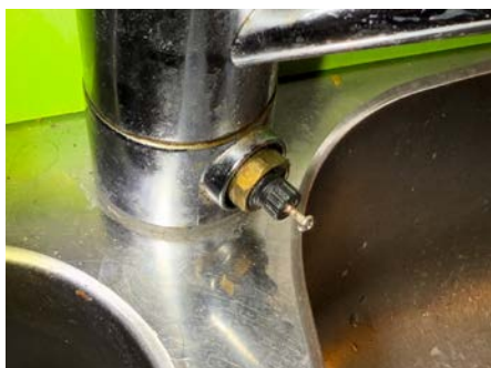
Defekt/falt av krandel for vann til oppvaskmaskin
