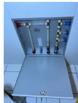
Rørskap i baderomshimling med stoppekraner
