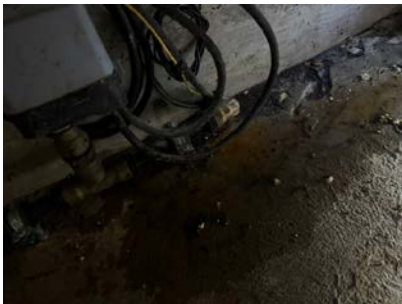
Drypplekkasje fra vannrør i kjeller.
