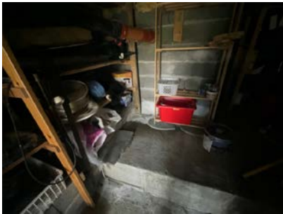
Vann trengte inn i bod, synlig fukt på betong under befarings
