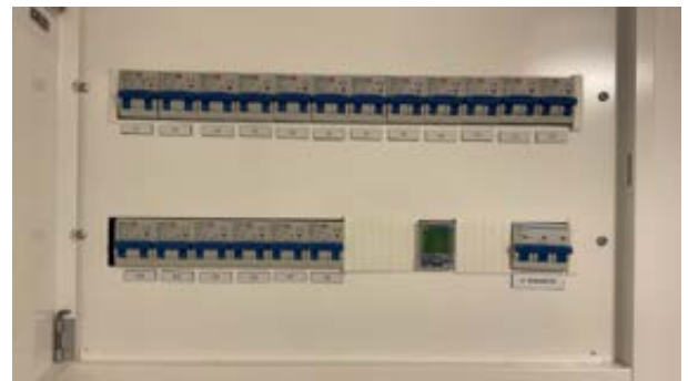
El-skap med automatsikringer
