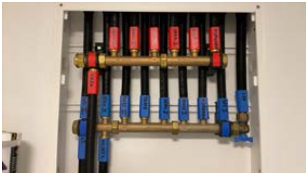
Fordelerskap med rør i rør opplegg
