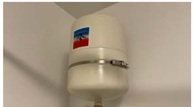
NB ! Ekspansjonstanker bør ha jevnlig service.
