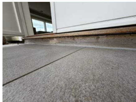
Manglende beslag undet balkongdør.
