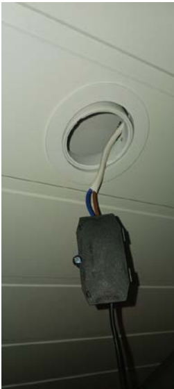
Bilde 1 Kabel for spotter er avmantlet utenfor kapsling.
