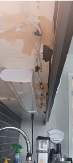
Bilde 1 Eldre lysrør armaturer bør skiftes ut til Led armaturer.
