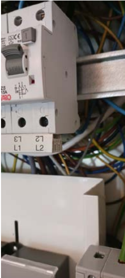
Bilde 1 Det mangler endekappe på samleskinne.
