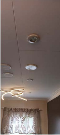
Bilde 1 Belysning (innfelt spotter) i tak kjøkken virker ikke/frakoblet.
