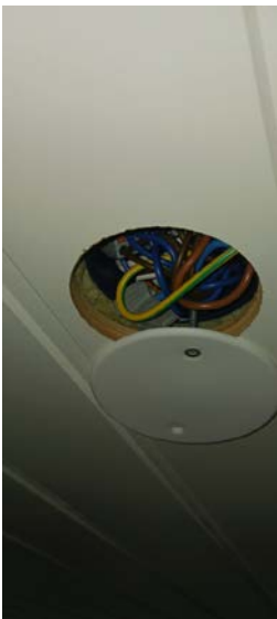
Bilde 3 Takbokser mangler utforingsring, isolasjon ligger så mot ledning.
