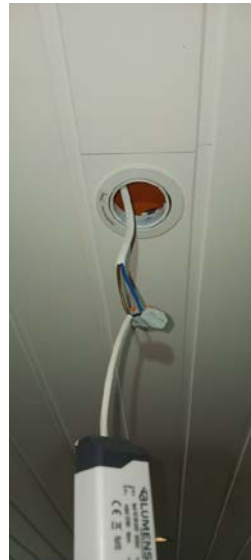
Bilde 2 Kabel/koblingsklemmer ligger mot brennbart (takplater). Spotter kommer med fastmontert ledning og kan i sånn måte ikke kobles på noen annen måte.
