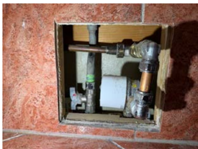
Stoppekraner bak åpning i baderomsvegg ved vaskemaskin.
