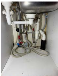
Røroplegg i kjøkkenbenk. Svelleskader i bunnplate.
